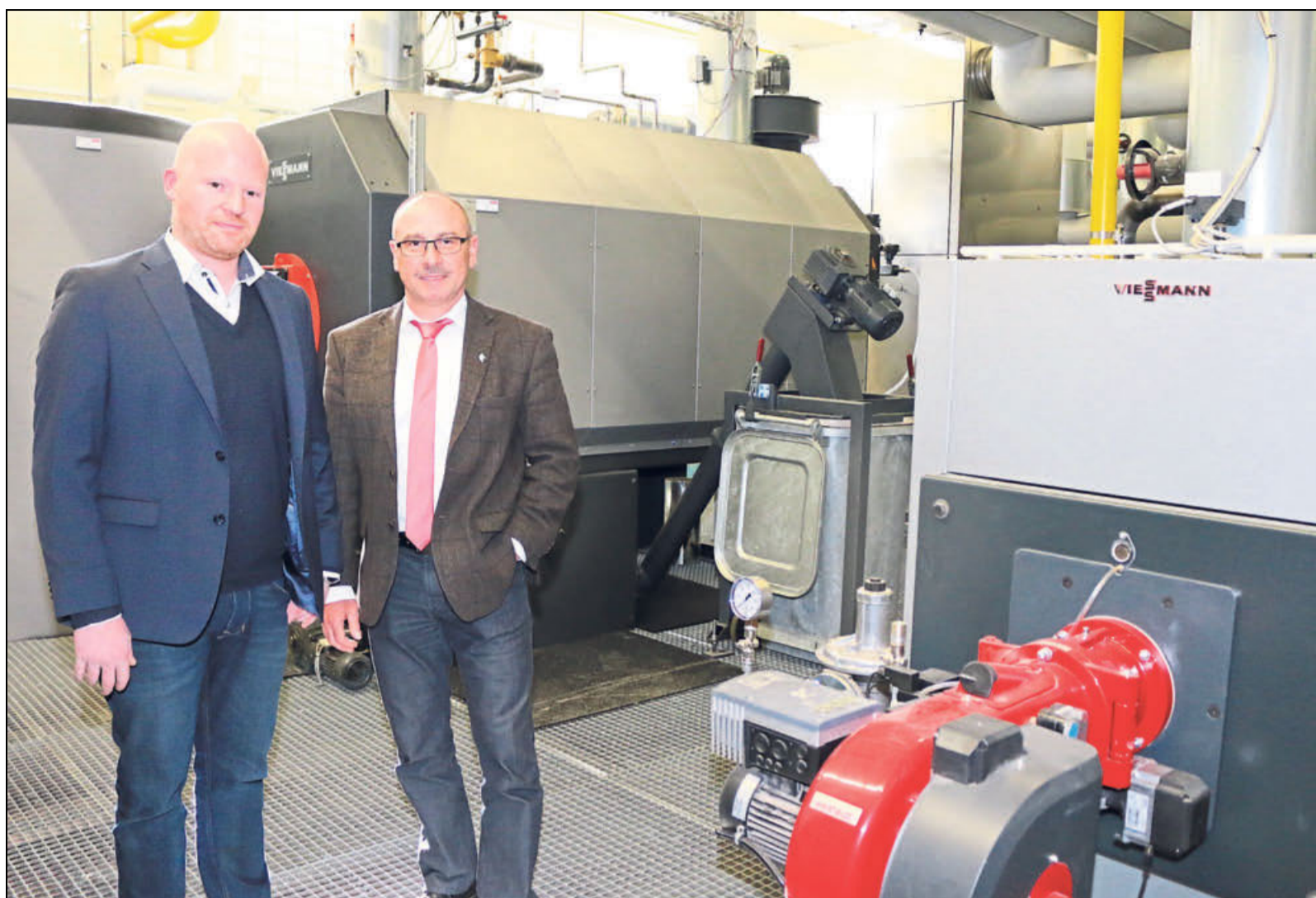
Im Lehrschwimmbecken steht jetzt die neue Heizzentrale: Christoph Niewels (links) und Bürgermeister Andreas Bee zeigen den Pelletgroßkessel (hinten links) und den Gasbrennwertkessel als Notkessel (vorne rechts). Foto: Sonja Möller
